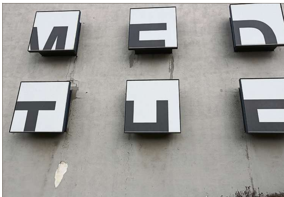
Etwas mehr als zehn Jahre alt ist die Mediothek am Schulzentrum Längenfeld – doch an der Fassade sind bereits deutliche Schäden sichtbar. Foto: Maier
